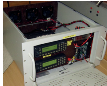
Umsetzer 2x Motorola GM1200 + Ablaufsteuerung im Servergehäuse
