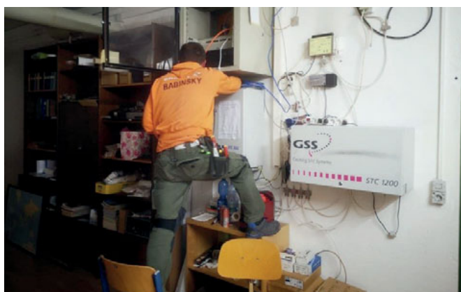
Manuel OE3AMQ beim Verkabeln des EDV-Schranks
